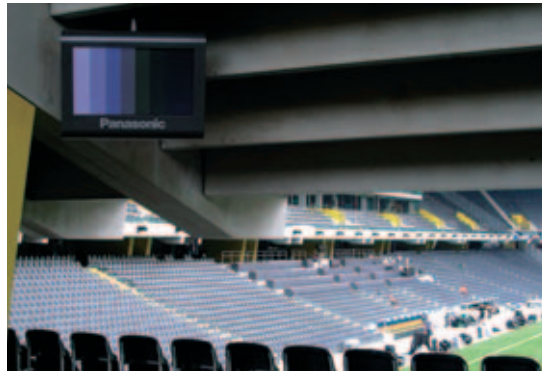
100 Inhouse-TV-Bildschirme werden über KNX/EIB angesteuert. (Bild: MbM Systems)
