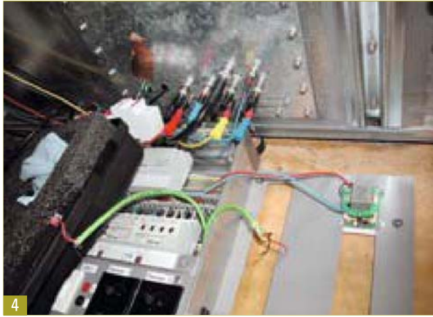
4 Wird der Schirm des KNX-Kabels bei der Einführung in die Absorberkammer geerdet, so können die Feldstärken um ca. 20 dB gesenkt werden und die Störungen, verursacht durch das KNX-Signal, sind nicht mehr sichtbar.
